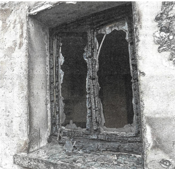
Sur place, les dégâts sont particulièrement visibles et conséquents.
